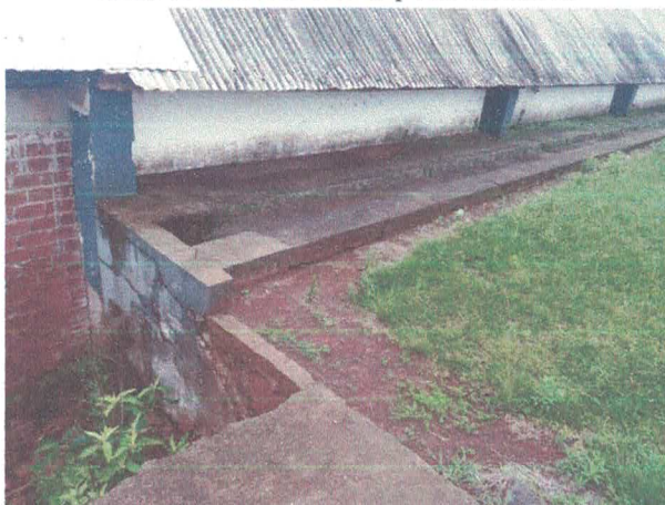
Figura 12 – Calha externa de concreto, onde uma parte será demolida e refeita. Toda a parte interna da calha de concreto será impermeabilizada.
