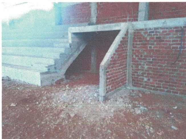
Figura 04 – Entrada para os vestiários, alvenaria receberá revestimento e pintura e arquibancada terá acabamento de cimento alisado.
