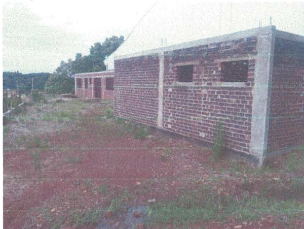
Figura 01 – Vista frontal, onde será executado revestimento e pintura sobre paredes, novos pilares, platibanda e marquise em concreto, bem como a cobertura em estrutura metálica.
