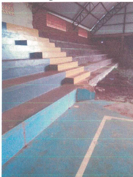
Figura 10 – Arquibancadas, que receberão acabamento em concreto liso e uma demão de pintura hidrofugante com silicone.
