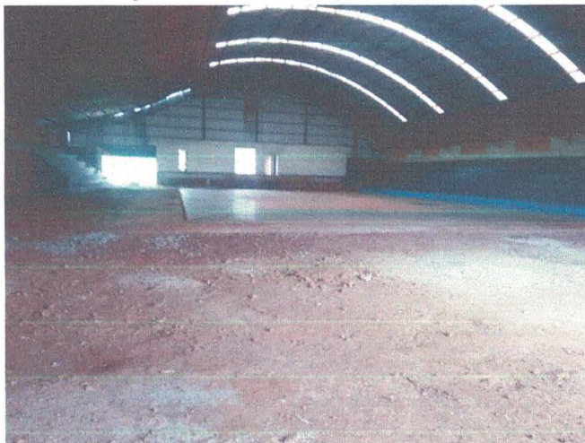
Figura 03 – Vista interna do ginásio, que receberá pavimentação de concreto com acabamento em tacos de madeira na quadra e acabamento polido no entorno da quadra.
